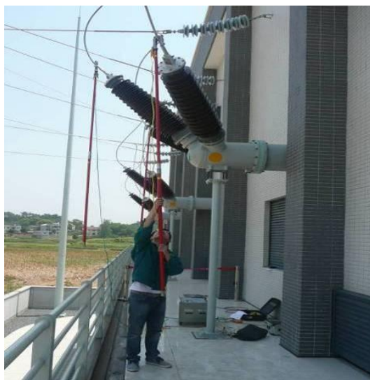
图 6-2：测试线通过绝缘棒引到被测线路上
